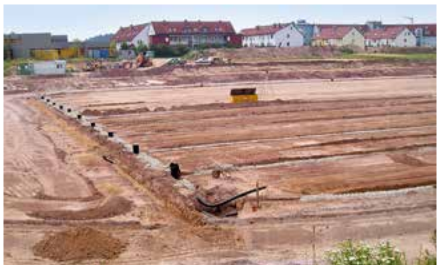
Beispielanordnung einer Spielfelddrainage (Großspielfeld 105 m x 68 m) mit stirnseitigen Kontrollschächten GALABAU- inspect und Dränrohren EURORAIN-PE/SIROPLAST-K
