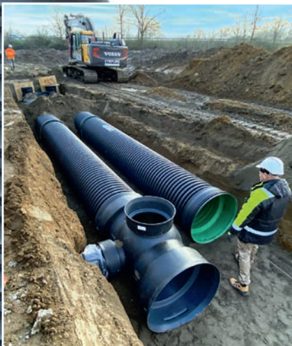
Beachtliches Rückstauvermögen bei zwei parallel verlegten AQUATUB-Rw DN 800 mit hydraulisch günstiger Querverteilung
