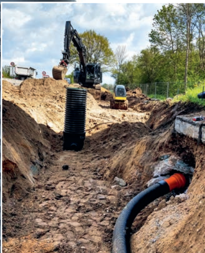
Anbindung der Straßenabläufe bei einem Überführungsbauwerk an die Streckenentwässerung
