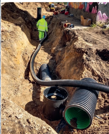
Schachtsystem MULTI-inspect DUO mit Transportrohr AQUATUB-Rw bei beengten Platzverhältnissen
